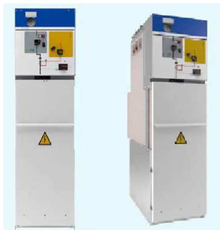
Ilustración 22: Celda de Media Tensión (Protección)
